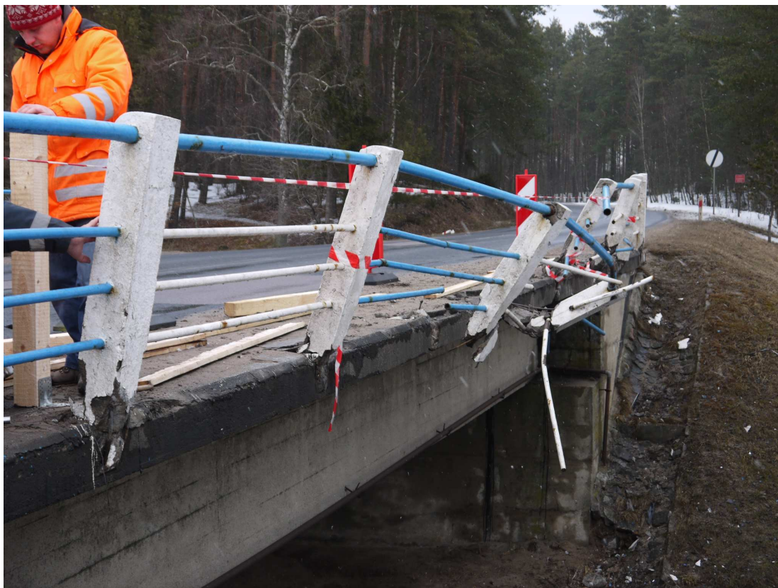
widok wzdłuż mostu na uszkodzoną balustradę
